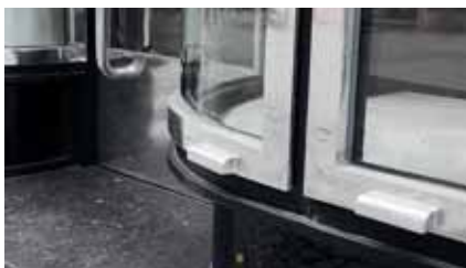
Obr. 19. Brno, „Convalaria“, architekt Oskar Poříška 1937, obnova architekti Jindřich Škrabal a Ludvík Grym. Příklad repasovaného ocelohliníkového výkladce s vložením dvojskla. (Foto Petr Všeťka.)
