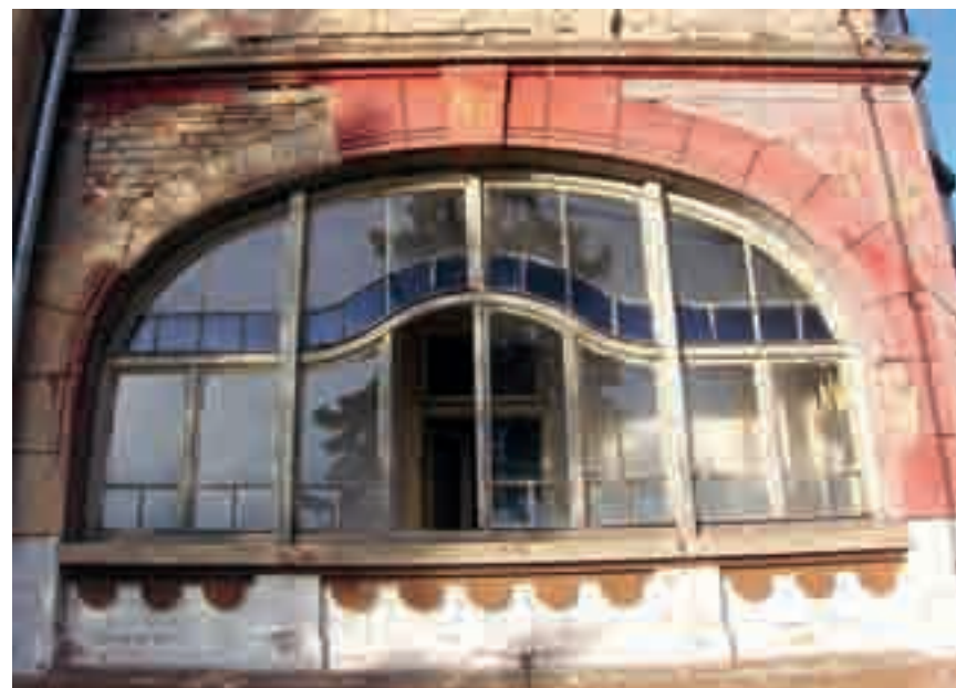
Obr. 33a. Zajímavě řešené a kvalitně provedené okno secesní budovy zaslouží citlivou opravu. Jeho hodnotu zvyšuje i použití barevného skla.
