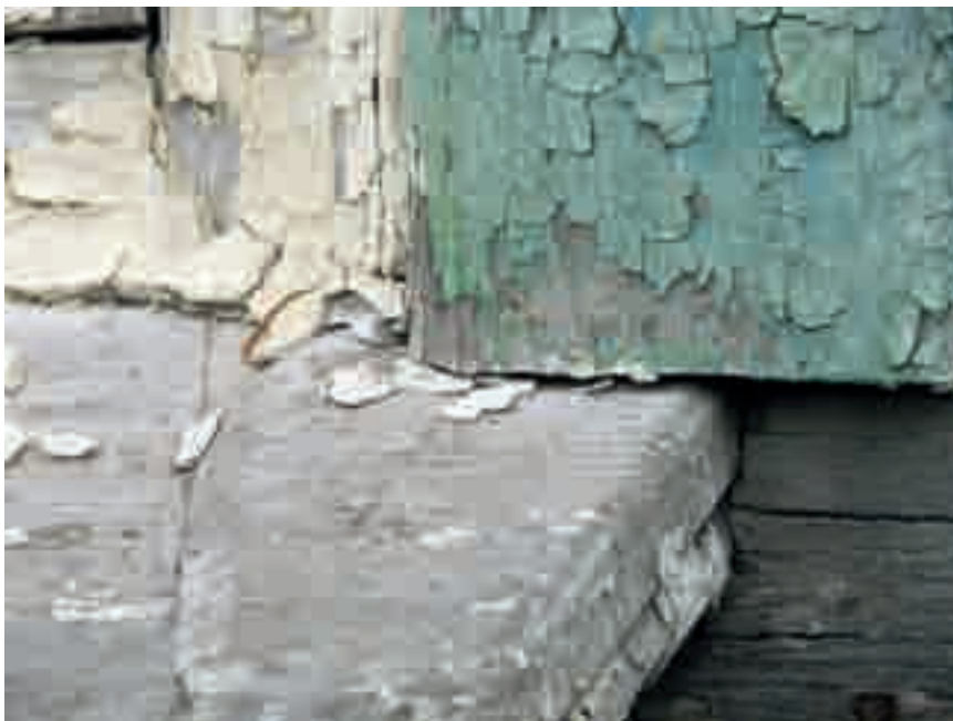
Obr. 2. Ukázka nevyhovujících nátěrů a povětrností poškozeného dřeva s charakteristickým šedým zbarvením.
