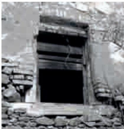
Obr. 2. Trámková zárubeň renesančního okna pevně zavázaná do zdiva přečnávajícími konci spodního trámku a překrytá mladší plentou.
