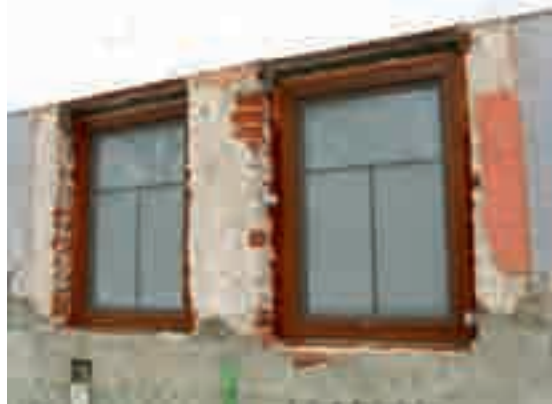
Obr. 26. Při výměně tradičních oken za plastová nebo dřevěná okna novějšího typu často dochází k zásahům do ostění.
